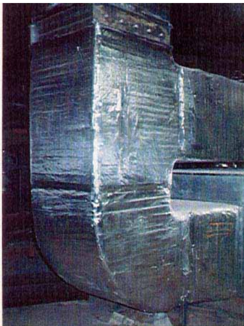
Σχήμα 8. Θερμομόνωση βιομηχανικών εγκαταστάσεων από πάπλωμα και με επικάλυψη αλουμινίου
