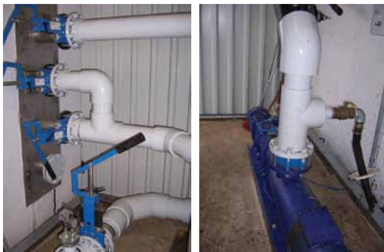
Σχήμα 7.8: Βαλβίδες διακοπής (αριστερά) και σύστημα άντλησης (δεξιά) (RUTZ 2006)
