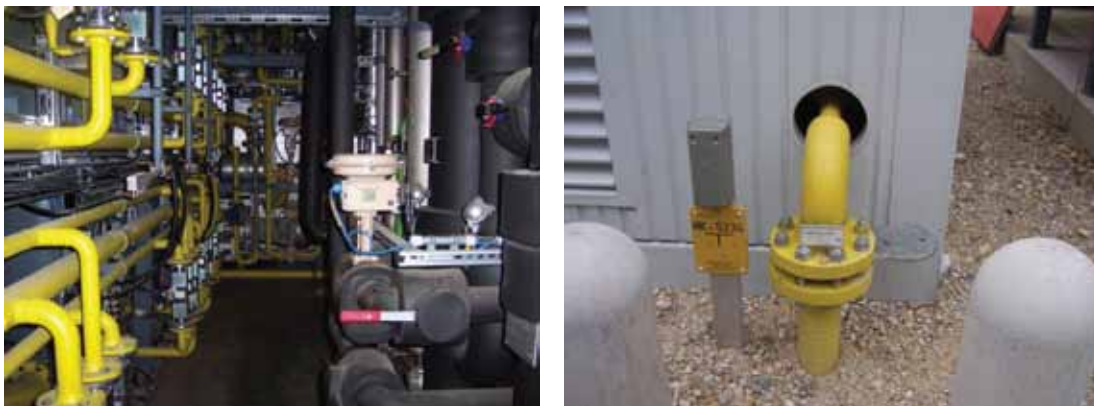
Σχήμα 5.7: Μονάδα συστήματος PSA (αριστερά) και σύνδεση με το δίκτυο φυσικού αερίου (δεξιά) της μονάδας βιομεθανίου στο Pliening, Γερμανία (RUTZ 2007)
