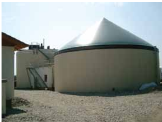
Σχήμα 4.7: Κατακόρυφη μονάδα βιοαερίου στη Γερμανία που κατασκευάστηκε το 2005 για τη χώνευση ενεργειακών καλλιεργειών (KRIEG & FISHER 2008)
