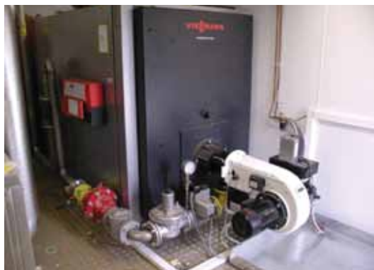
Σχήμα 5.2: Καυστήρας βιοαερίου για παραγωγή θερμότητας (AGRINZ 2008)
