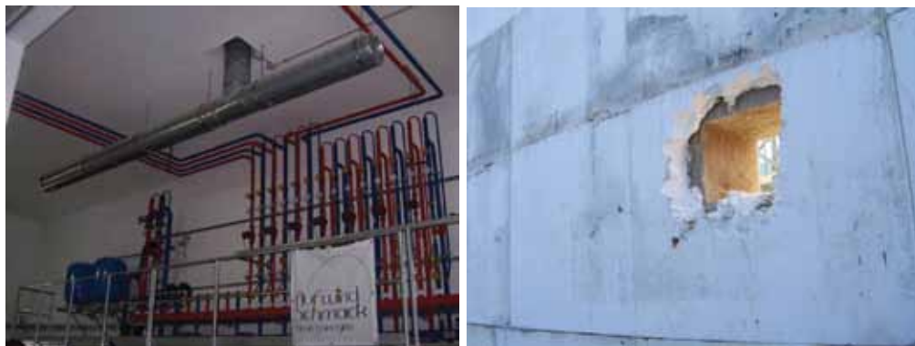
Σχήμα 7.16: Σύστημα θέρμανσης μιας μονάδας βιοαερίου (αριστερά) και μόνωση ενός τσιμεντένιου χωνευτή που είναι υπό κατασκευή (δεξιά) (RUTZ 2008)
