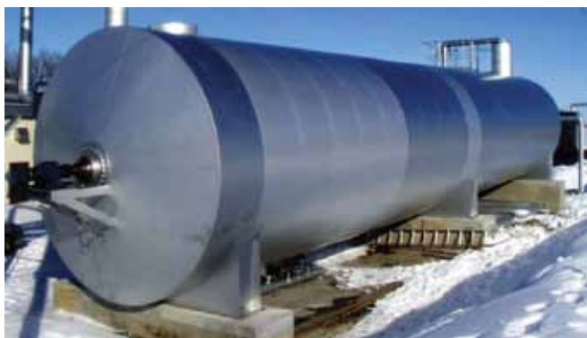
Σχήμα 4.3: Οριζόντιος χωνευτής, κατασκευασμένος στην Δανία (Nordisk Folkecenter 2001)
