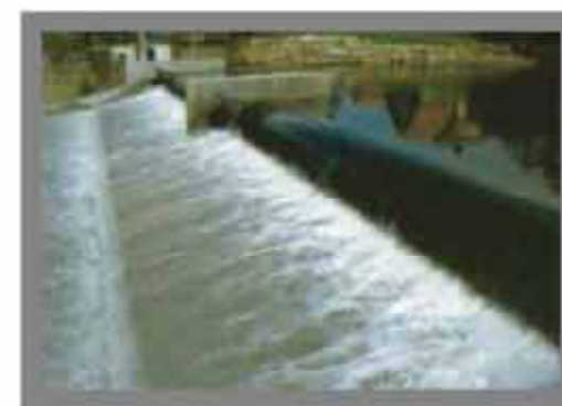
Σχήμα 6.4. Υδροφράκτης ενός μικρού υδροηλεκτρικού σχήματος εκτροπής [Πηγή: Βιβλ., Μικρά Υδροηλεκτρικά, 1]
