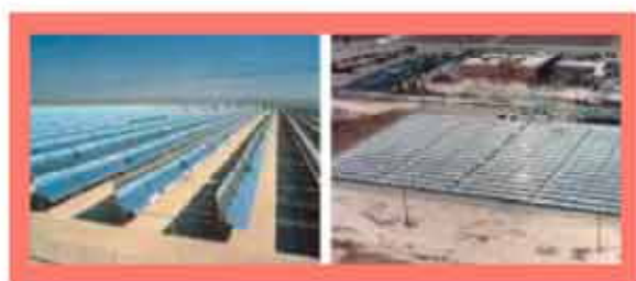
Σχήμα 4.8. Φωτογραφίες από σταθμούς ηλεκτροπαραγωγής παραβολικών κοίλων [Αριστερά: Kramer Junction – Δεξιά: Gould Electronics]
